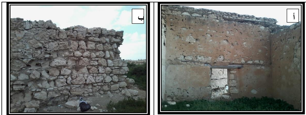
شكل (٧): أثر الحرارة في انفصال الطبقات السطحية من الجدران في صورة قشور أ- بالطابق العلوي لحواصل حصن برج (٣) (متجهاً صوب الغرب)، ب- الواجهة الشرقية لحواصل حصن برج (٤) (متجهاً صوب الشرق).
