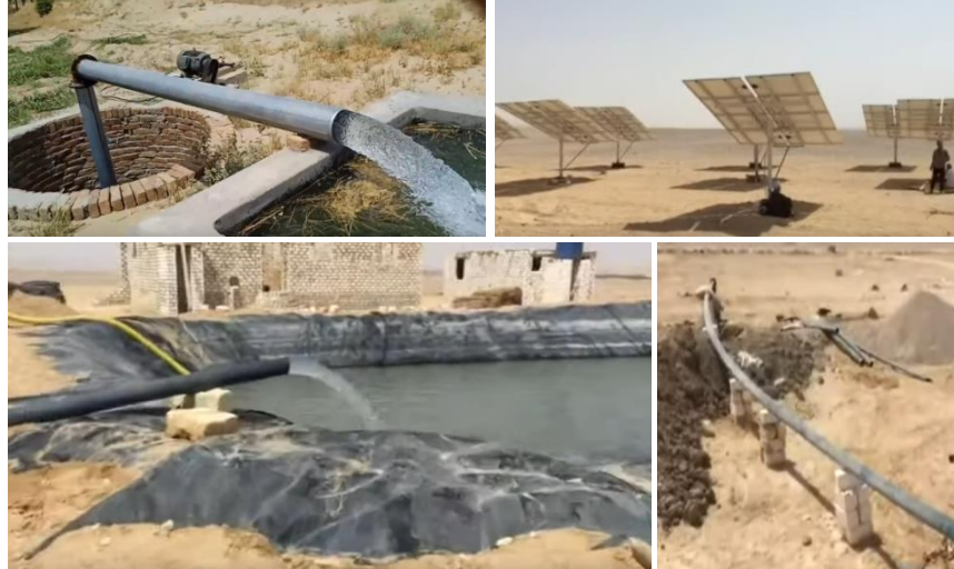
صورة (2) توضح استخدام الطاقة الشمسية في عمليات سحب المياه الجوفية بواسطة محرك 25 حصان بوادي طريق قنا الصحراوي (الكيلو 80) .
