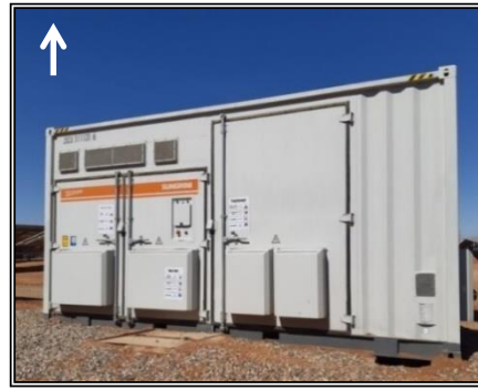
صورة (٥) : محول لنقل الكهرباء في محطة إنفينيتي.
