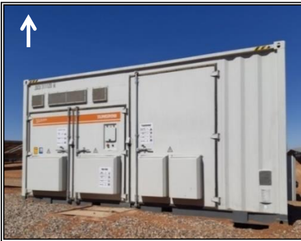
صورة (٦) : غرفة التحكم بمحطة محولات بنبان (٣).
