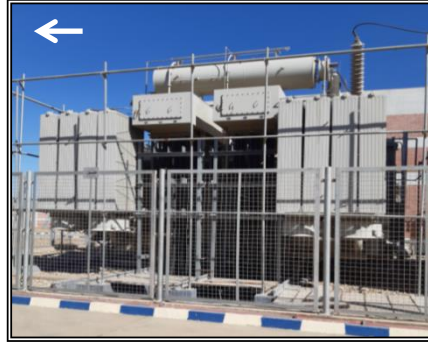
صورة (١) : محولات رفع الجهد بمحطة بنبان (٢).
