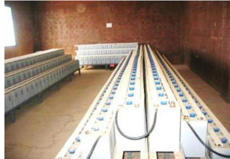
صورة (٧) غرفة البطاريات داخل محطة المحولات بنبان ٢
