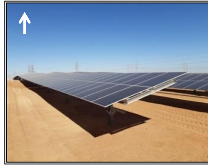
صورة (٣) : الألواح الشمسية في محطة إنفينيتي.
