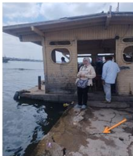
صورة ( ١ ) توضح عدم تماسك الرصيف النهري، واقترب مستوى المياه من سطح الرصيف - مرسى الأندصارى.
