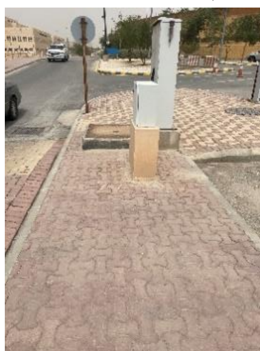
شكل رقم ٤١: عدادات الكهرباء في وسط مسار الحركة
