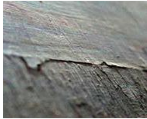
صورة (٣) توضح الشروخ بالجهة اليسرى بالشال
